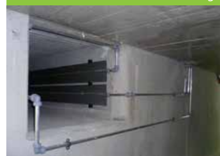
Variante: Unterflurzuluft mit Heizung
