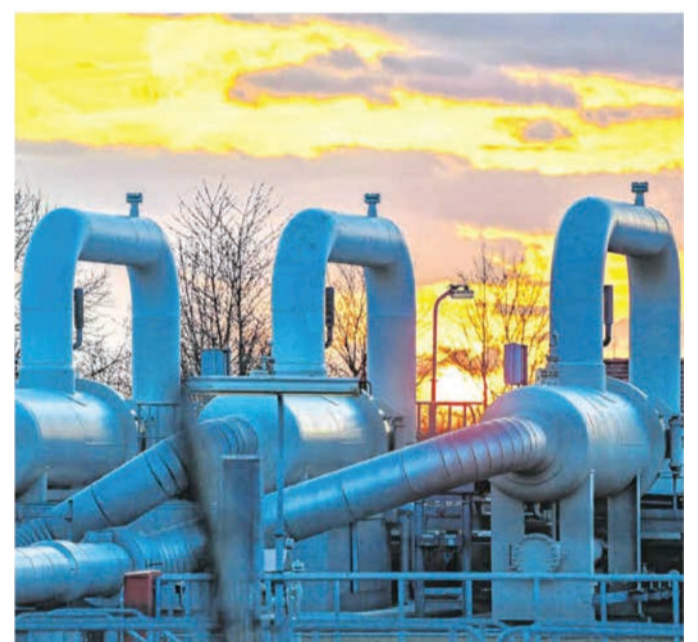
Die Wirtschaft braucht Energie. Diese Verdichterstation nahe der deutsch-polnischen Grenze übernimmt vorwiegend russisches Erdgas aus Russland. Foto: Patrick Pleul/dpa
